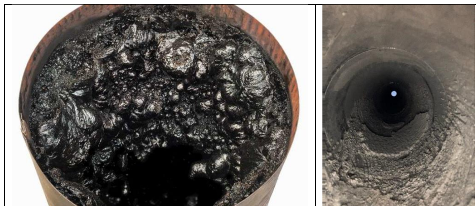
Figuur 10: Brandbare (links) en niet brandbare (rechts) materialen in het rookgaskanaal.
