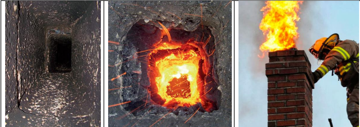
Figuur 13: Rookgaskanaal met brandbare afzettingen en schouwbrand.
